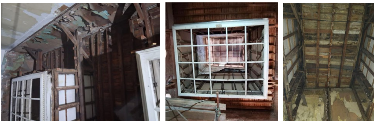
>> Figura 22 - 24: Cielo falso y lucarna situación existente en sala de conferencias. Fuente: Elaboración propia.
