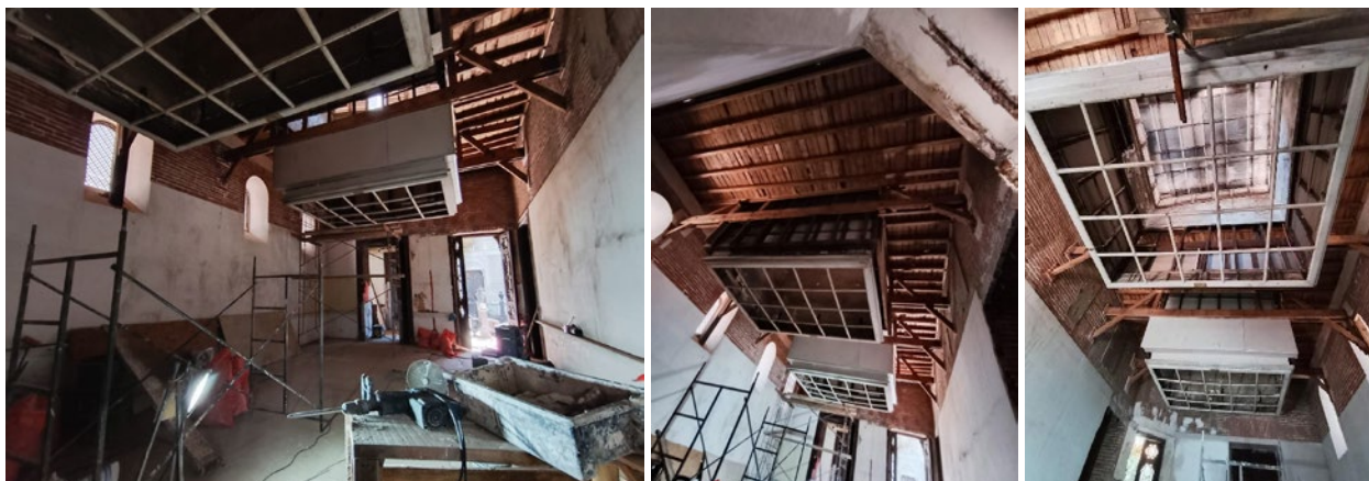
>> Figura 5–7. Muro sur sala de conferencias y estado actual de lucarnas y detalle de carpintería ornamental con deterioro superficial asociado a humedad histórica, evidenciando pérdida de terminación y acumulación de material, sin comprometer su integridad estructural. Registro enero de 2026. Fuente: elaboración propia.
